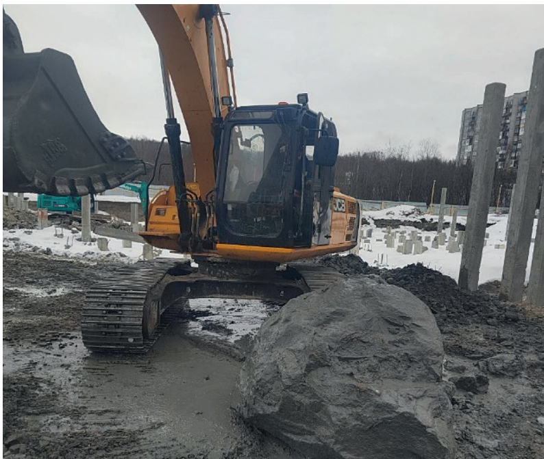
Рис. 1. Валуны, обнаруженные в грунте, на объекте строительства крытого бассейна в г. Североморске, Мурманская область
