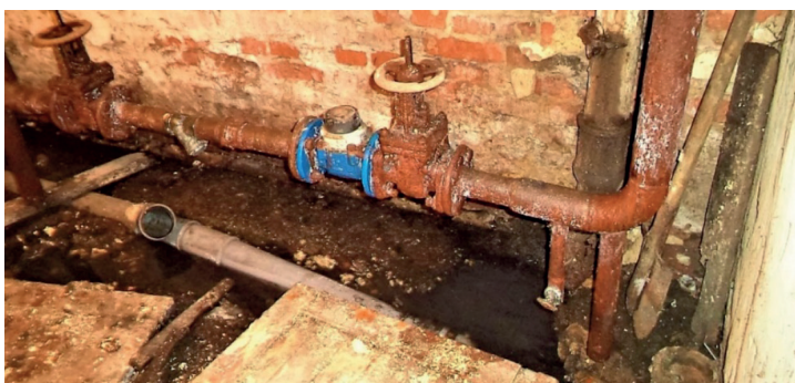
Рис. 1. Коррозия системы водоснабжения
