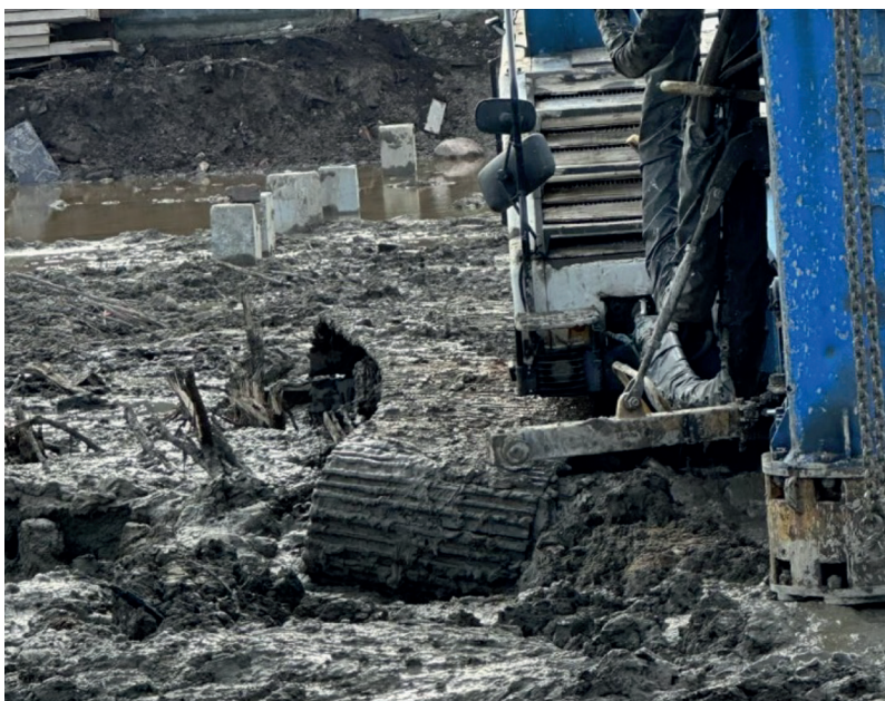
Рис. 3. Поломка ходовой части сваебойной установки из-за отсутствия насыпного основания на объекте строительства производственно-складского комплекса в Санкт-Петербурге
