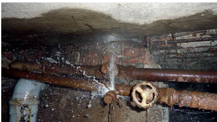
Рис. 2. Протечка системы теплоснабжения
